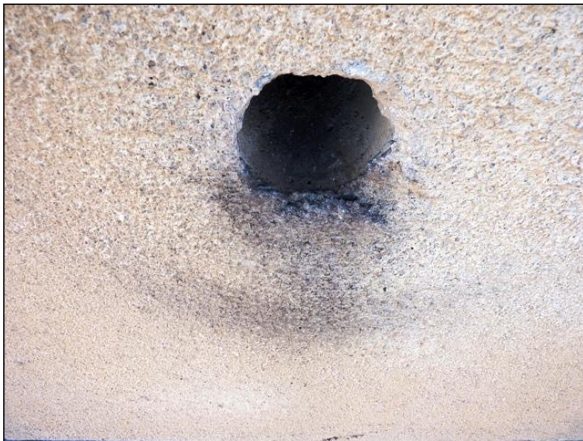
Znečištění fasády pod ventilačním otvorem, způsobené otěrem rýdovacích per pěvců
