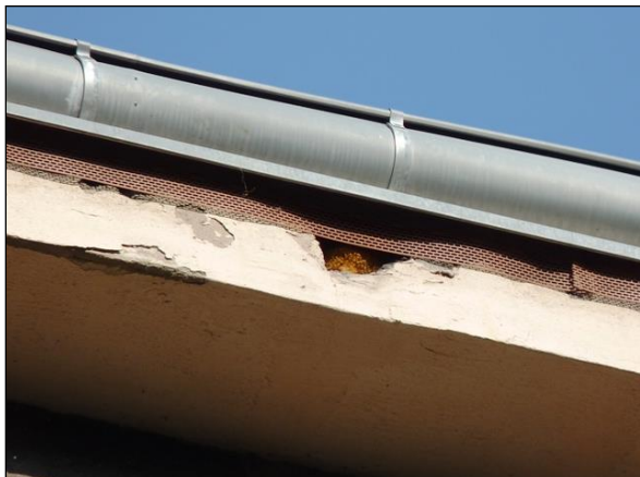
Detail poškození římsy – vletový otvor do hnízda
