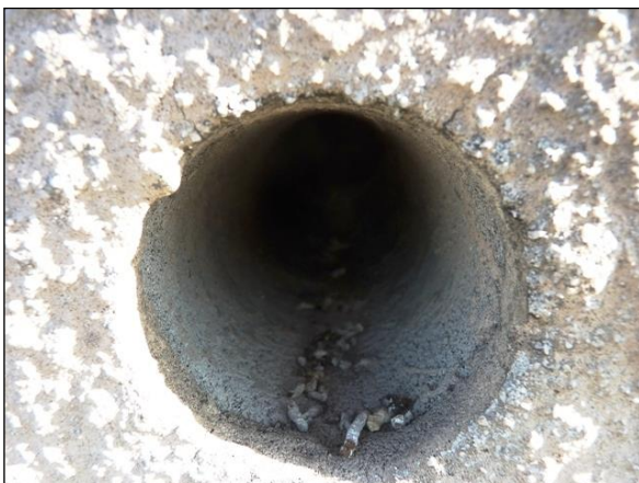
Trus drobných pěvců v ústí ventilačního otvoru
